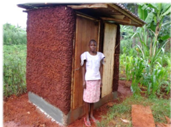
Neue Toilette/Dusche von Lydia
